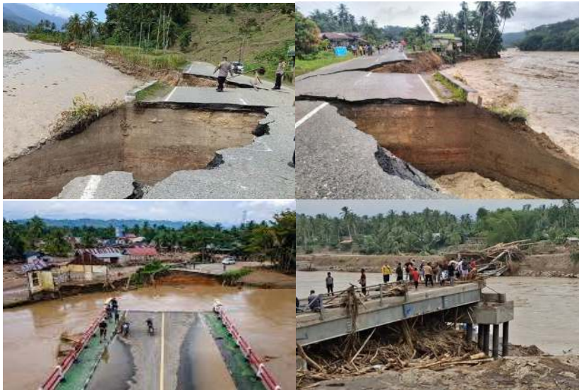
Gambar 2. Kerusakan Jalan dan Jembatan Sumber : PUPR Aceh, BPBA, BJPN (2025)
